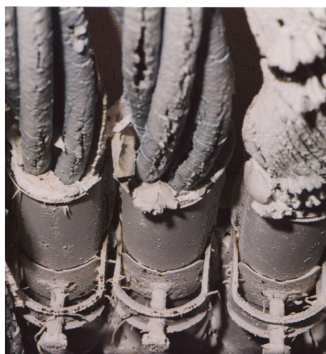
kábelvályú + bilincs rögzítés 90 perces 1000 C-os lángpróba után
